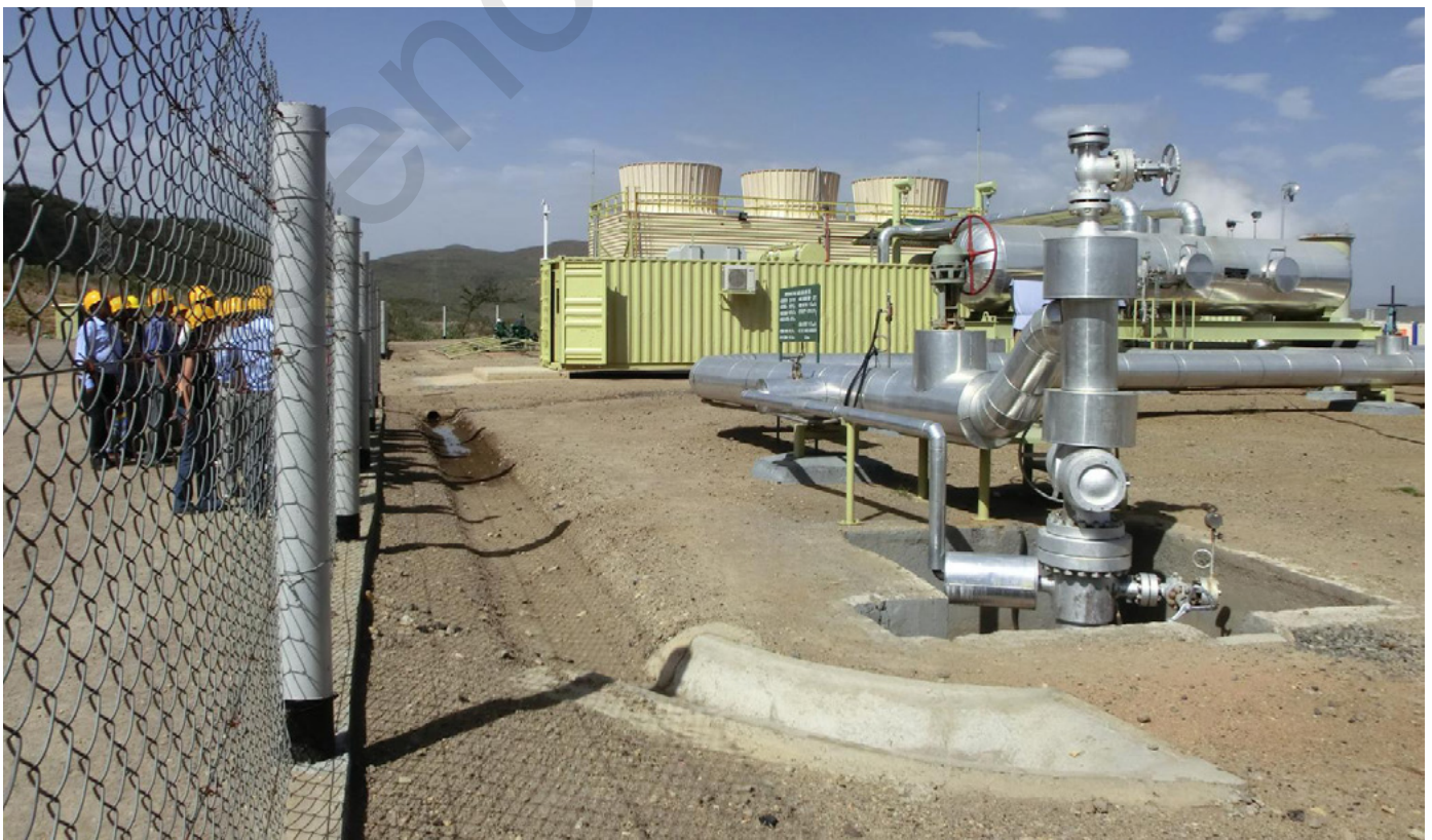
Olkaria geothermal plant, Kenya. Frank Van Der Vleuten/ Flickr
